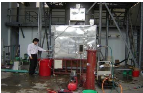
Hình 9. Hệ thống tuyển nổi áp lực tại Nhà máy nước Trường An
